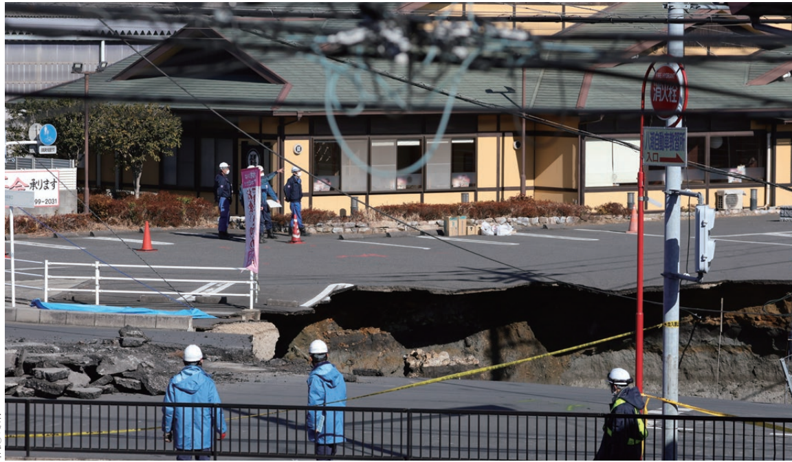
埼玉県八潮市での道路の陥没事故では近隣住民は避難したり、下水道の使用を自粛したりしました。
