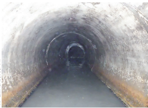
古くなると汚水が流れにくくなり、汚水などから発生した硫化水素が空気に触れることで発生した硫酸が下水道管を溶かします。
