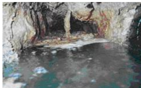
油が固まった下水道管
